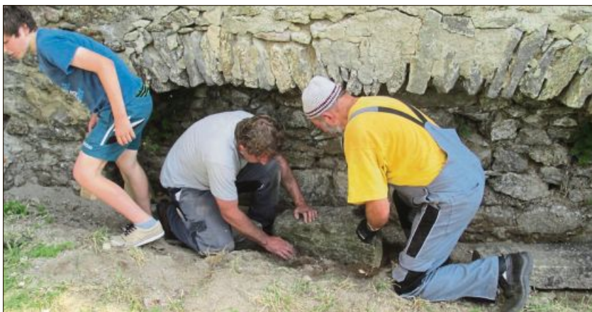
Dieses Gewölbe musste gestützt werden. Für die Arbeiten an und um die Burgruine sind stets viele Helfer im Einsatz.
